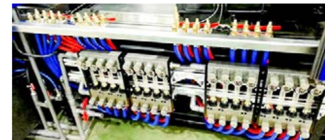
圖 4：冷卻水的流量監控 (速利達公司提供)
